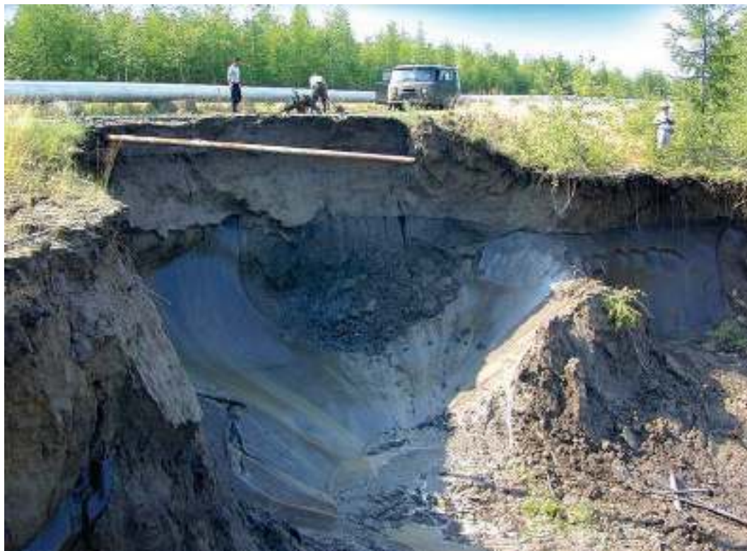
Рисунок 7 – Надземный трубопровод в Якутии, проложенный по территории с реликтовыми мощными повторно-жильными льдами (фото А.Н. Федорова, Институт мерзлотоведения) [Станиловская, Мерзляков, 2013]
